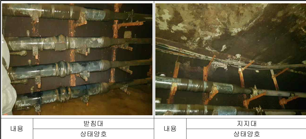
【사진 14.48】 부속 및 부대설비 현황
