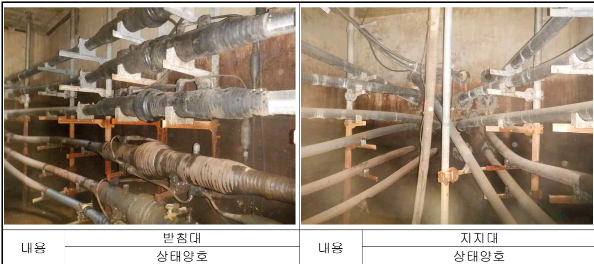
【사진 14.4】 부속 및 부대설비 현황
