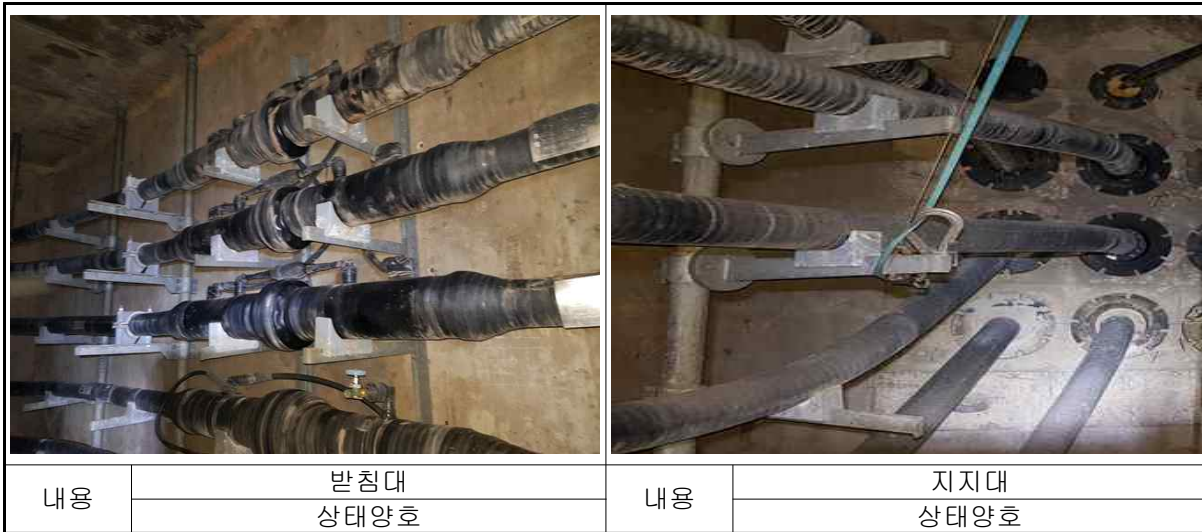
【사진 14.44】 부속 및 부대설비 현황
