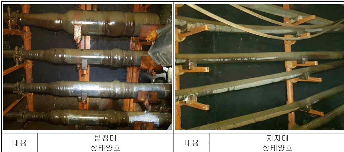
【사진 14.12】 부속 및 부대설비 현황
