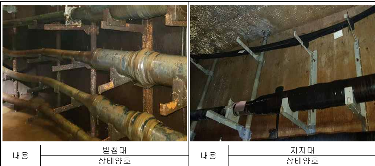
【사진 14.24】 부속 및 부대설비 현황
